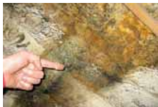
Das Salzbergwerk Gorleben im März 2008: Zuflüsse von Kohlenwasserstoffen deutlich sichtbar
